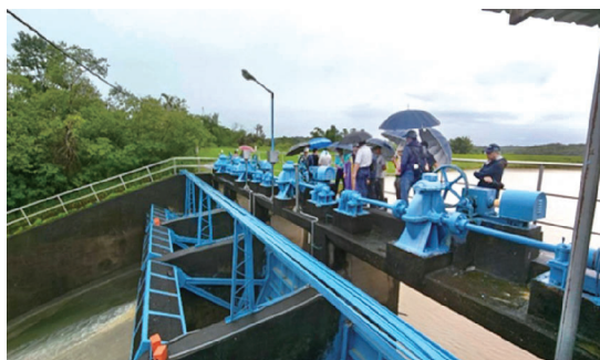
經濟部水利建造物安全評估小組等專家人員現勘鹽水埤水庫溢洪道底板受損情形(相片提供張朱明)
