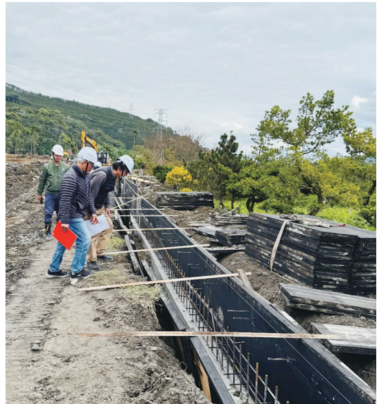
114年度興泉圳支分線等改善工程現地督導(相片提供顏嘉慧)
