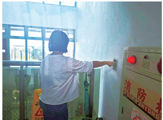
進行消防設備巡檢(照片提供者白雅雯)
