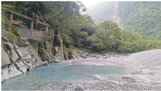
北埔圳進水口非固定式導水路與土砂堆積現況
