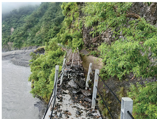
大津進水口巡防道路受山崩砂石掩埋路面擠壓毀損道路護欄
