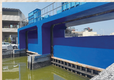
右1 嘉南管理處-芒子芒埤 右2 雲林管理處-濁幹線鹿場課圳進水口 右3 南投管理處-溪埧本圳制水閘門 右4 屏東管理處-鵝內埤進水口閘門
